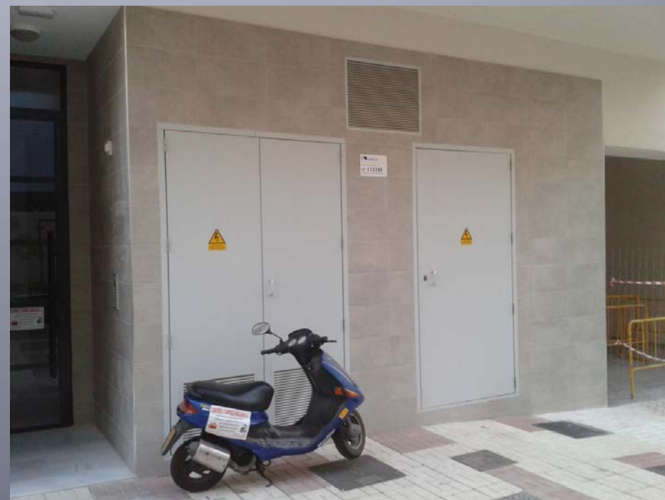
Centro de transformación interior (Ruiz Jaramillo, J., 2017)
