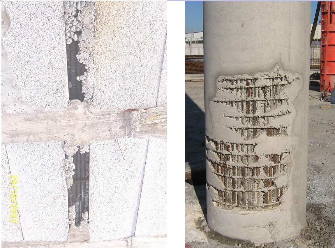
Figura 27b. Patologías por incumplimiento de distancias entre armaduras
