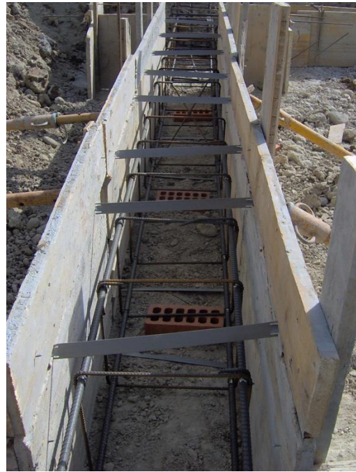
Figura 25. Uso inadecuado de separadores
