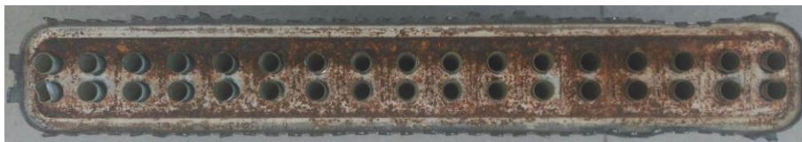
Figura 18. Módulo de fijación de los tubos corroído.
