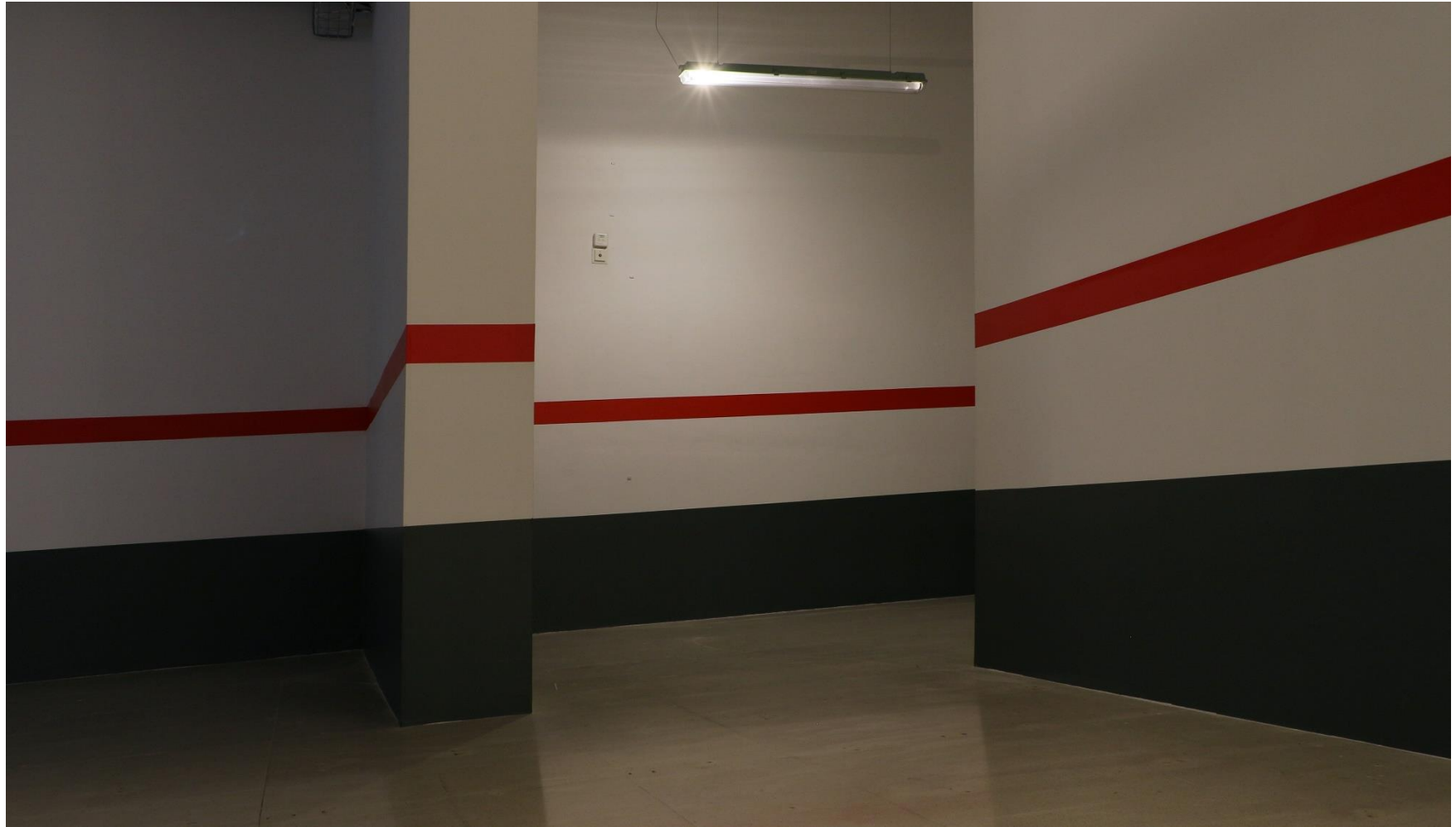
Pantalla estanca de la instalación
