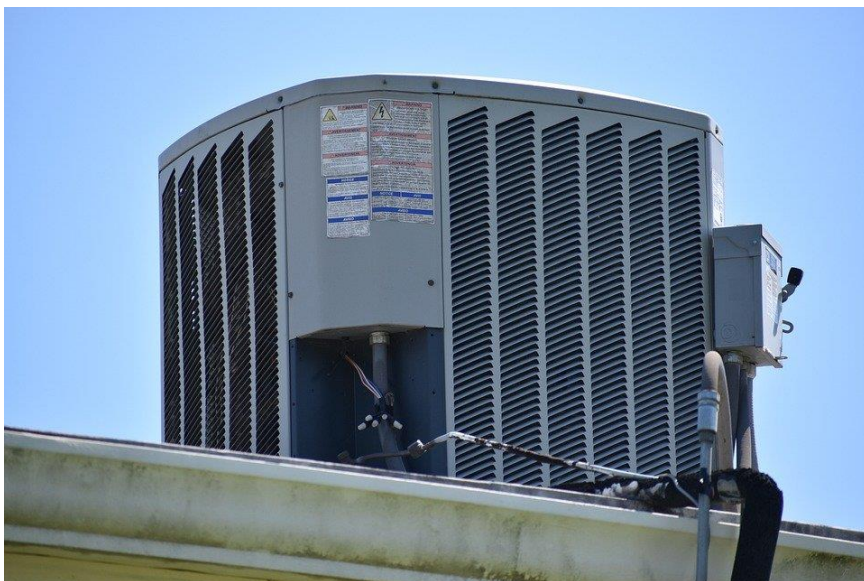
Ilustración 1: Ejemplo de unidad de refrigeración instalada en un edificio
