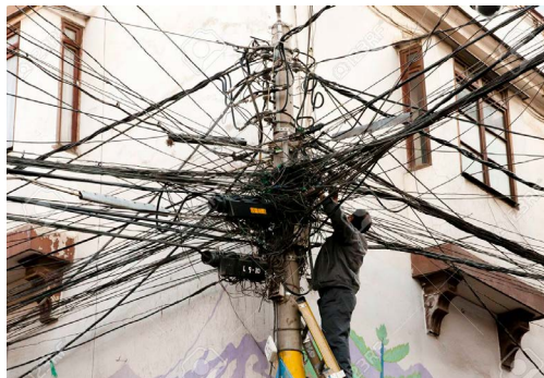
Fig. 29. Cableado de un poste eléctrico
