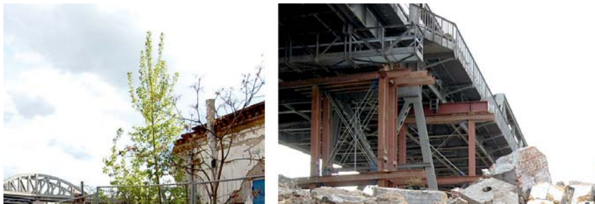
fig. IX: Obras que se están realizando en la zona de Gleisdreieck, refuerzo de estructuras y desmantelado de los antiguos almacenes y cocheras, 2012.
