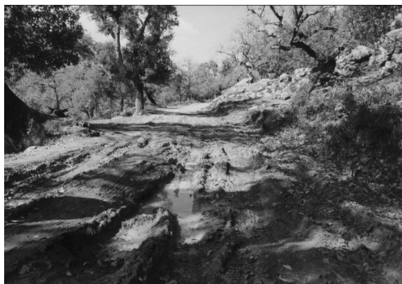
Roderas generadas por el paso de vehículos todo terreno sobre un firme arcilloso (Parque Natural Alcornocales, Málaga, 2002)
