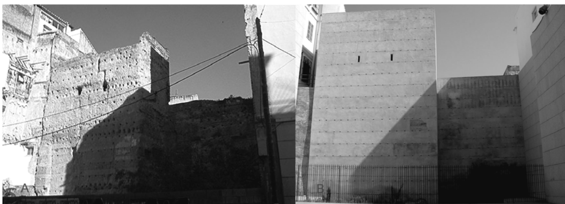
Lám. 24. Málaga, muralla de la ciudad (calle Carretería). A) Fragmento de un lienzo de la muralla, 2002. B) El mismo fragmento tras su “restauración”, 2006
