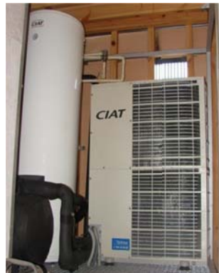
Figura 6: Integración de la bomba de calor en el módulo técnico.
