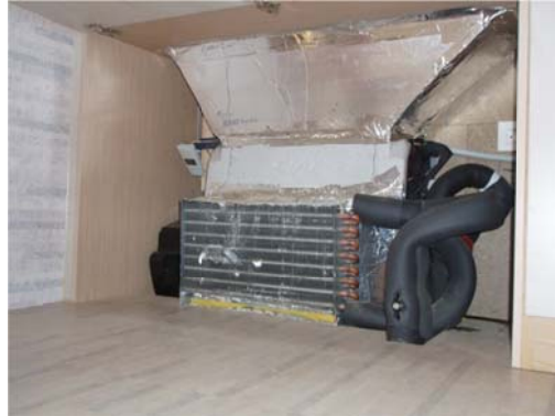
Figura 8: Imagen de la batería de free-cooling y fancoil
